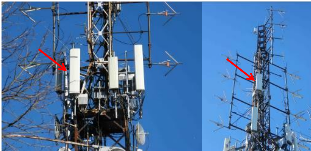
Slika 2.3. Fotografije antenskog sistema i bazne stanice operatera Cetin na lokaciji
