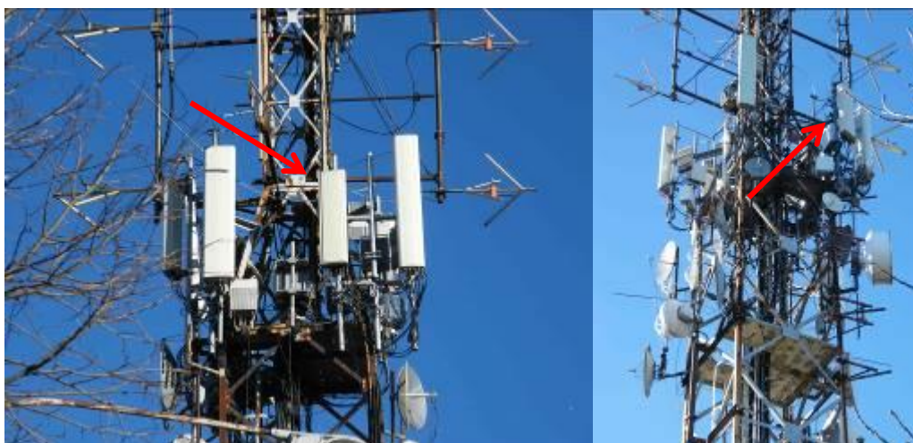
Slika 2.2.a Fotografije antenskog sistema i kabineta predmetne bazne stanice operatera Telekom Srbija
