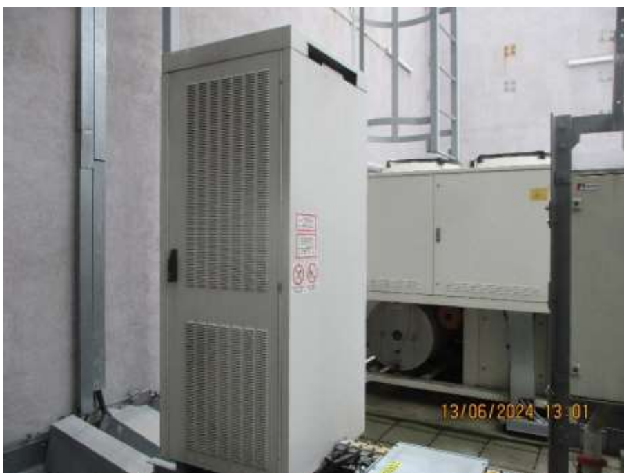
Slika 2.5 Prikaz kabineta bazne stanice
