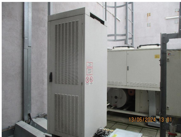
Slika 4: Prikaz kabineta bazne stanice
