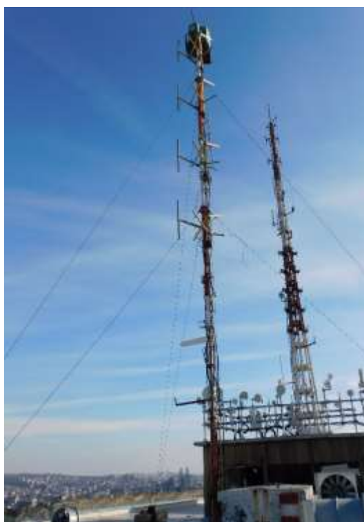
Slika 2.5 Fotografija antenskog sistem predmetne radio stanice
