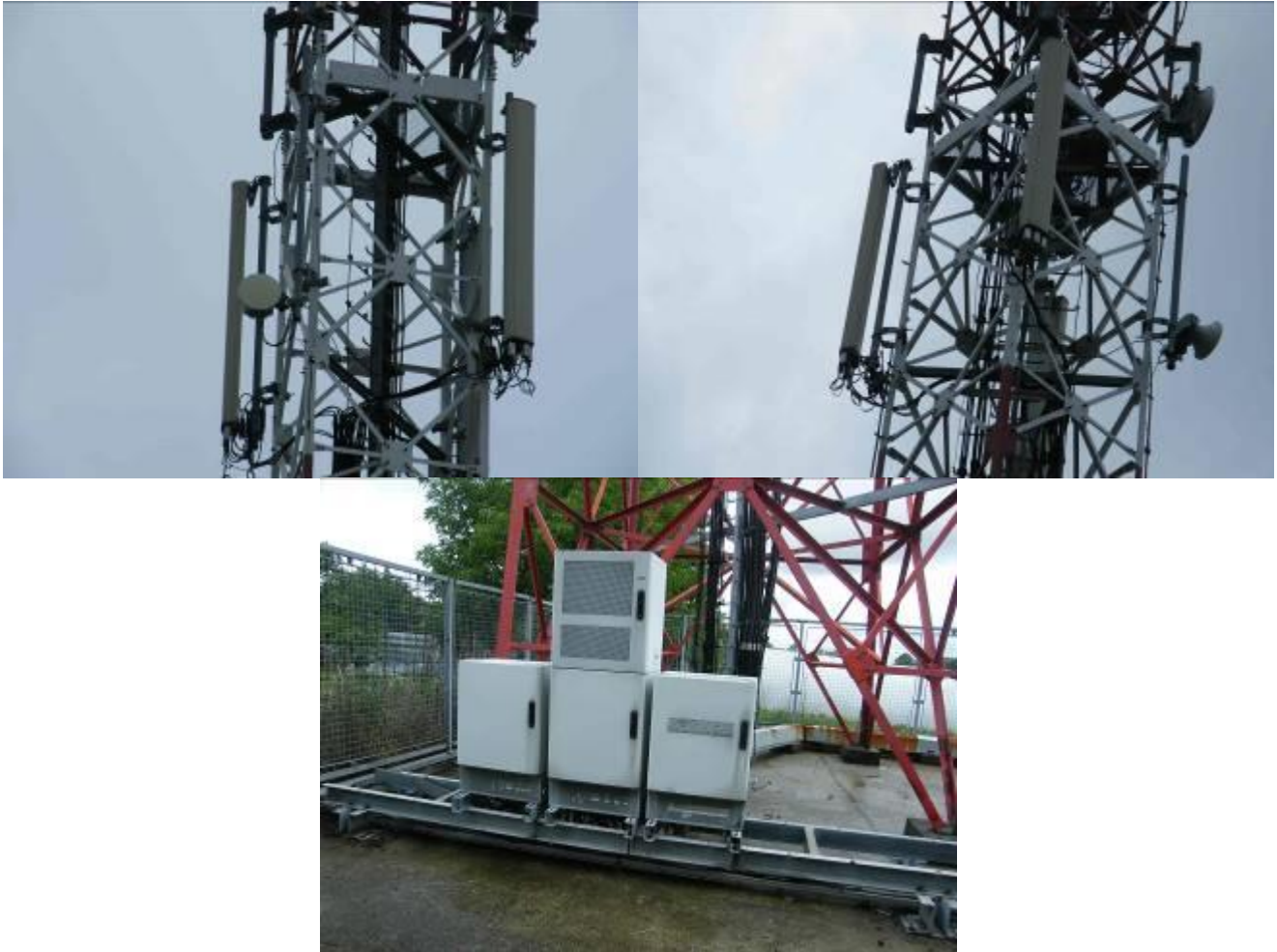
Slika 2.3. Fotografije antenskog sistema i bazne stanice operatera Cetin na lokaciji
