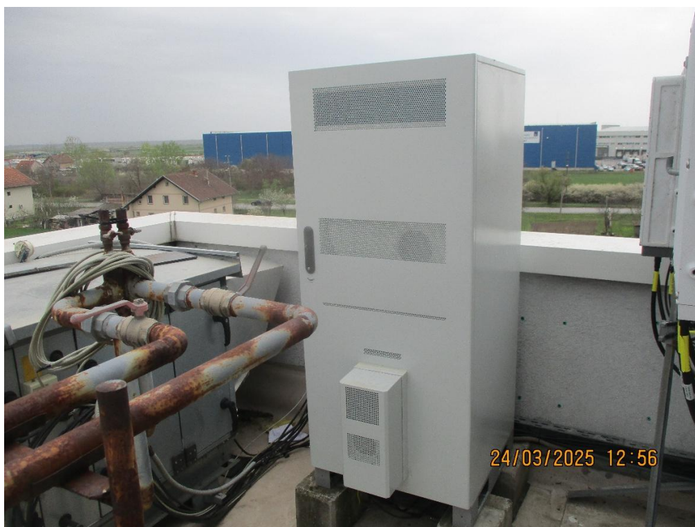
Slika 6 : Prikaz kabineta bazne stanice
