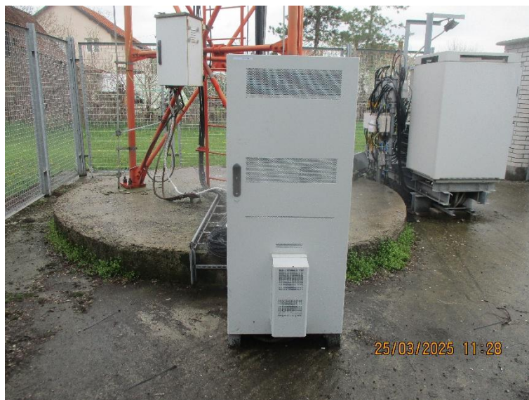
Slika 5 : Prikaz kabineta bazne stanice
