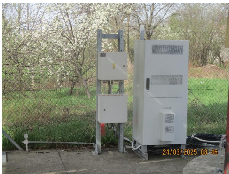
Slika 5 : Prikaz kabineta bazne stanice
