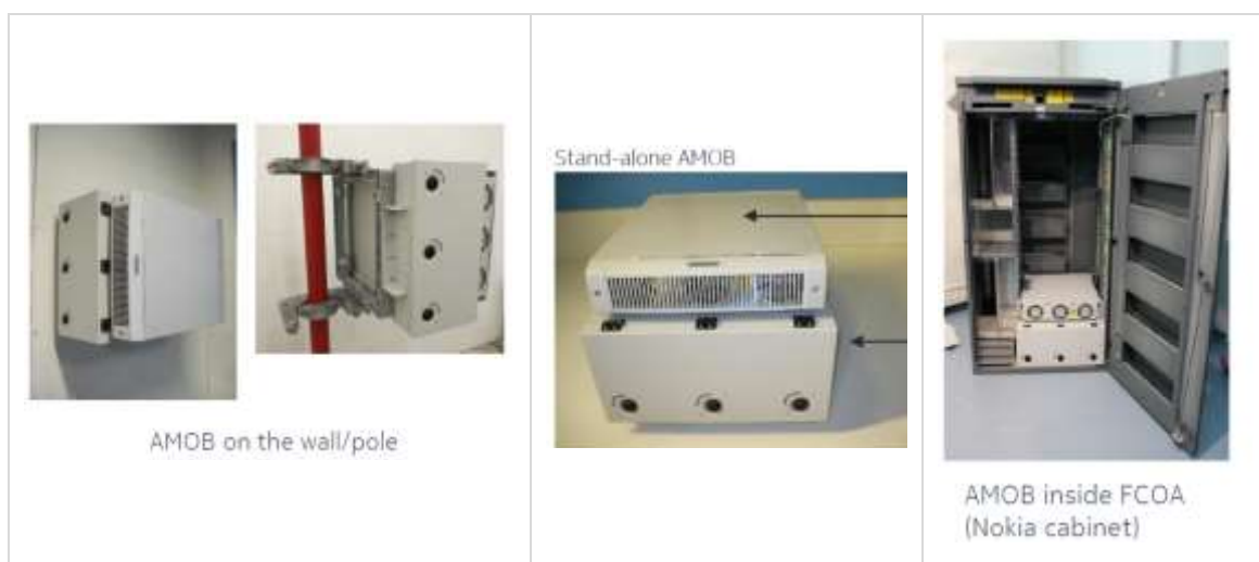
Slika 3.2 AMOB kućište instalacija
