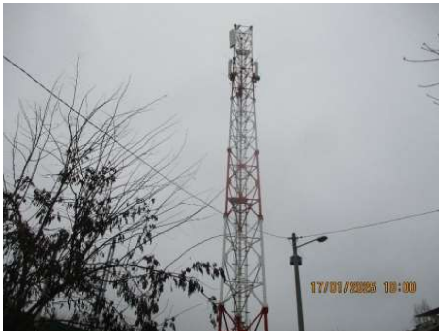
Slika 2.4 Prikaz antenskog stuba na lokaciji bazne stanice
