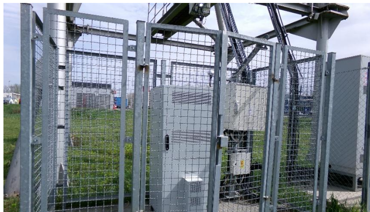
Slika 5 : Prikaz kabineta bazne stanice
