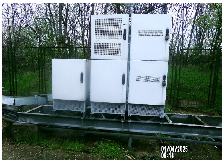
Slika 7 : Prikaz kabineta bazne stanice
