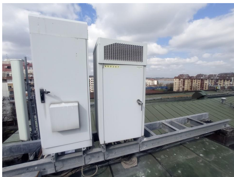
Slika 7 : Prikaz kabineta bazne stanice
