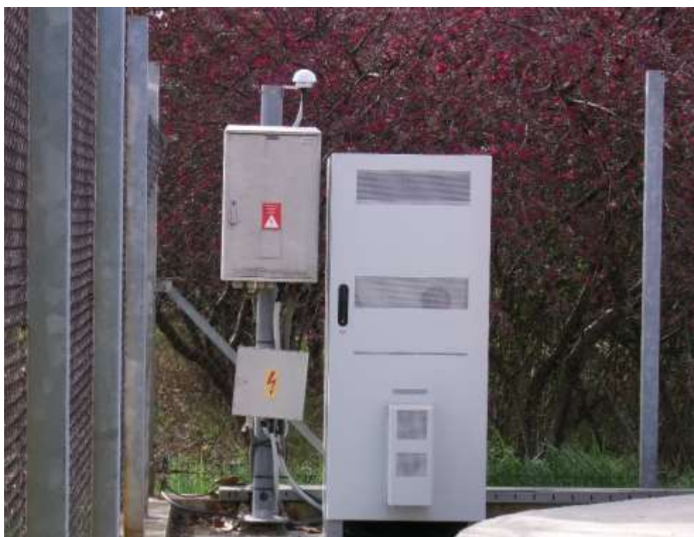
Slika 7 : Prikaz kabineta bazne stanice
