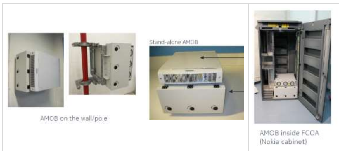
Slika 3.2 AMOB kućište instalacija
