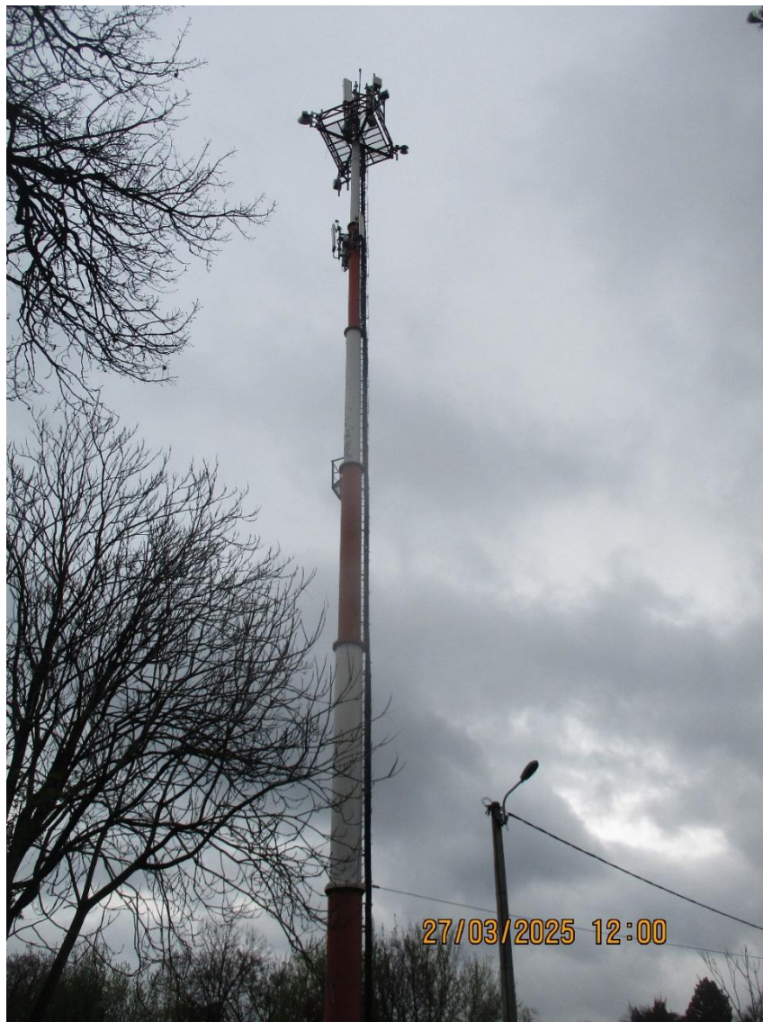
Slika 2.4 Prikaz antenskog stuba na lokaciji bazne stanice
