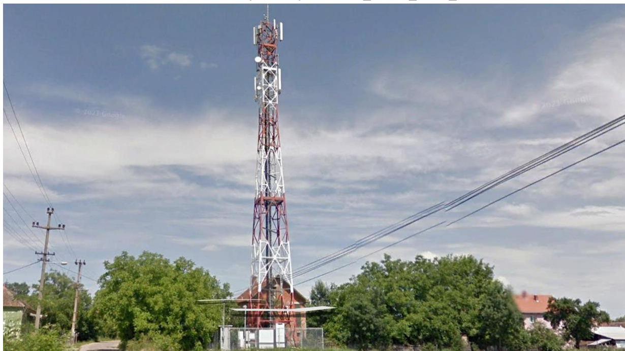
Slika 2.2 Izgled stuba na kom je postojeća bazna stanica BG0787_01 BG_Veliki_Borak
