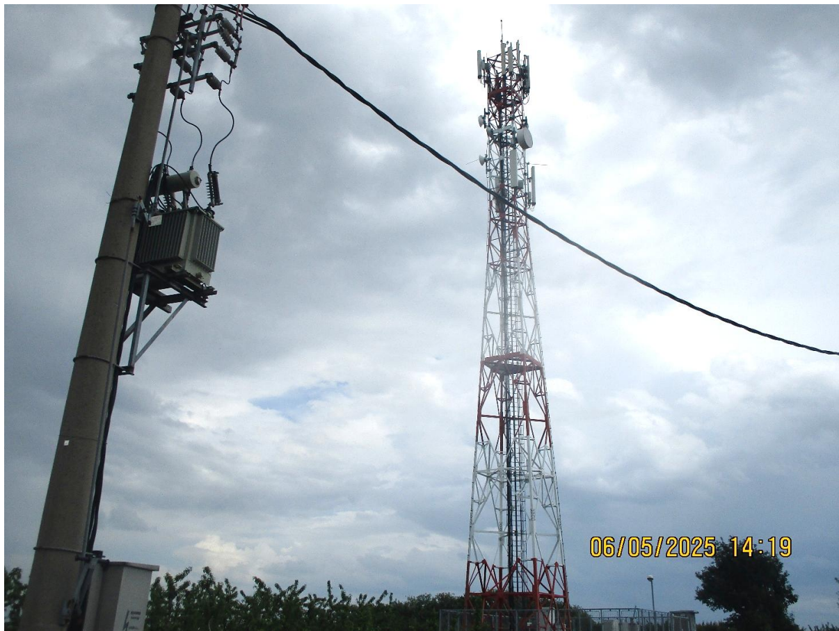
Slika 2.4 Prikaz antenskog stuba na lokaciji bazne stanice
