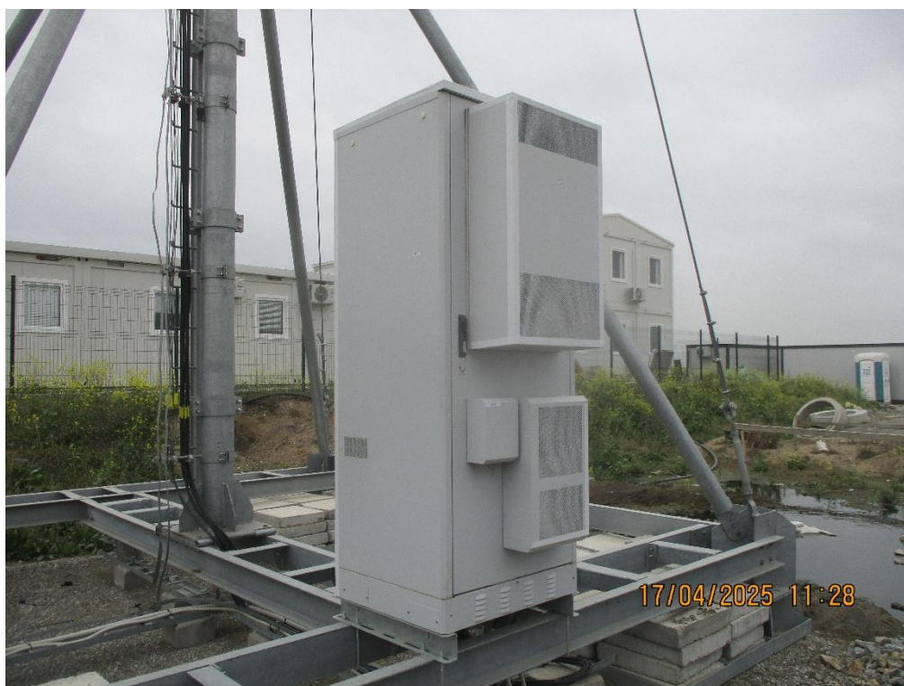
Slika 6 : Prikaz kabineta bazne stanice
