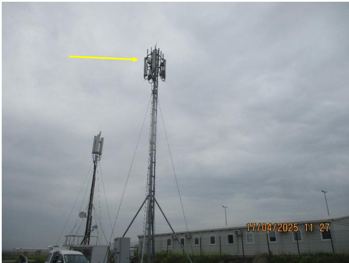
Slika 2.4 Prikaz stuba na kom je montirana bazna stanica
