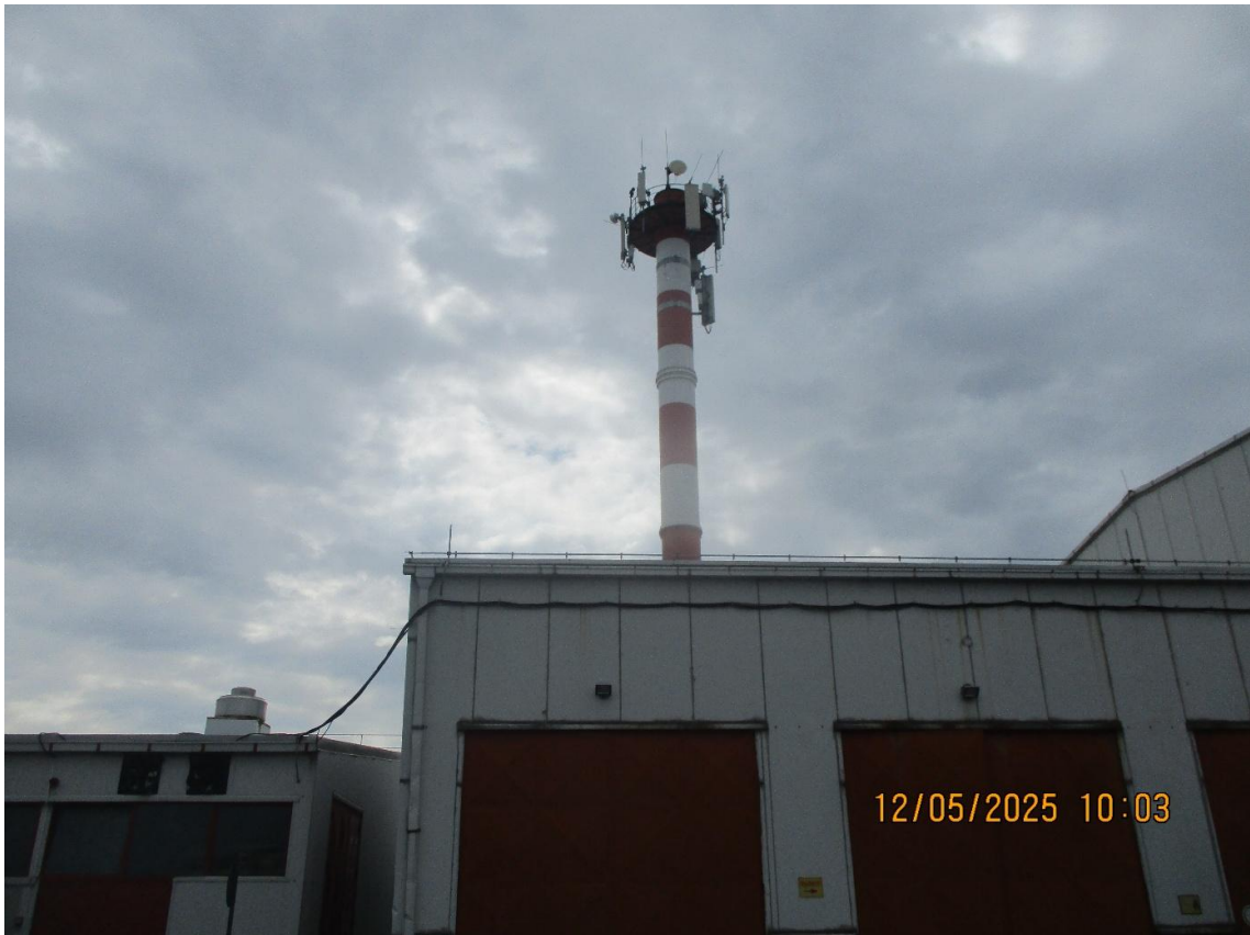
Slika 3: Prikaz dimnjaka na kom su montirane antene Telekom Bazne Stanice
