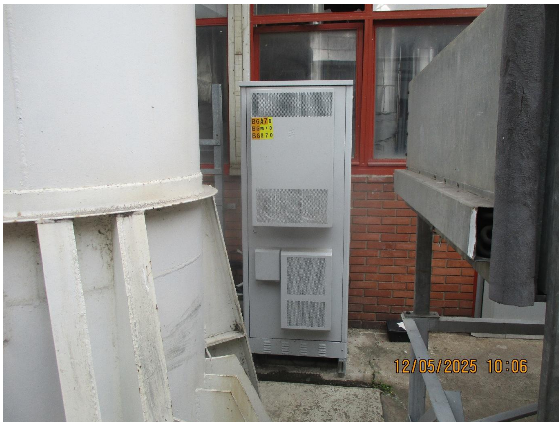
Slika 3: Prikaz kabineta bazne stanice
