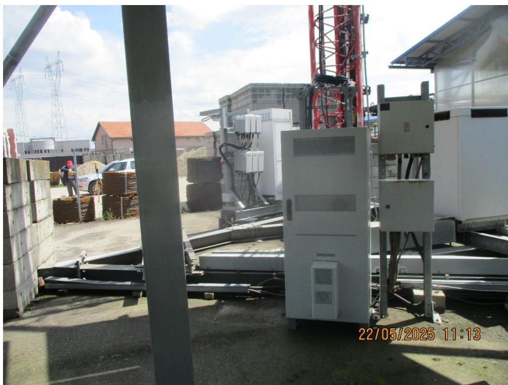
Slika 5 : Prikaz kabineta bazne stanice
