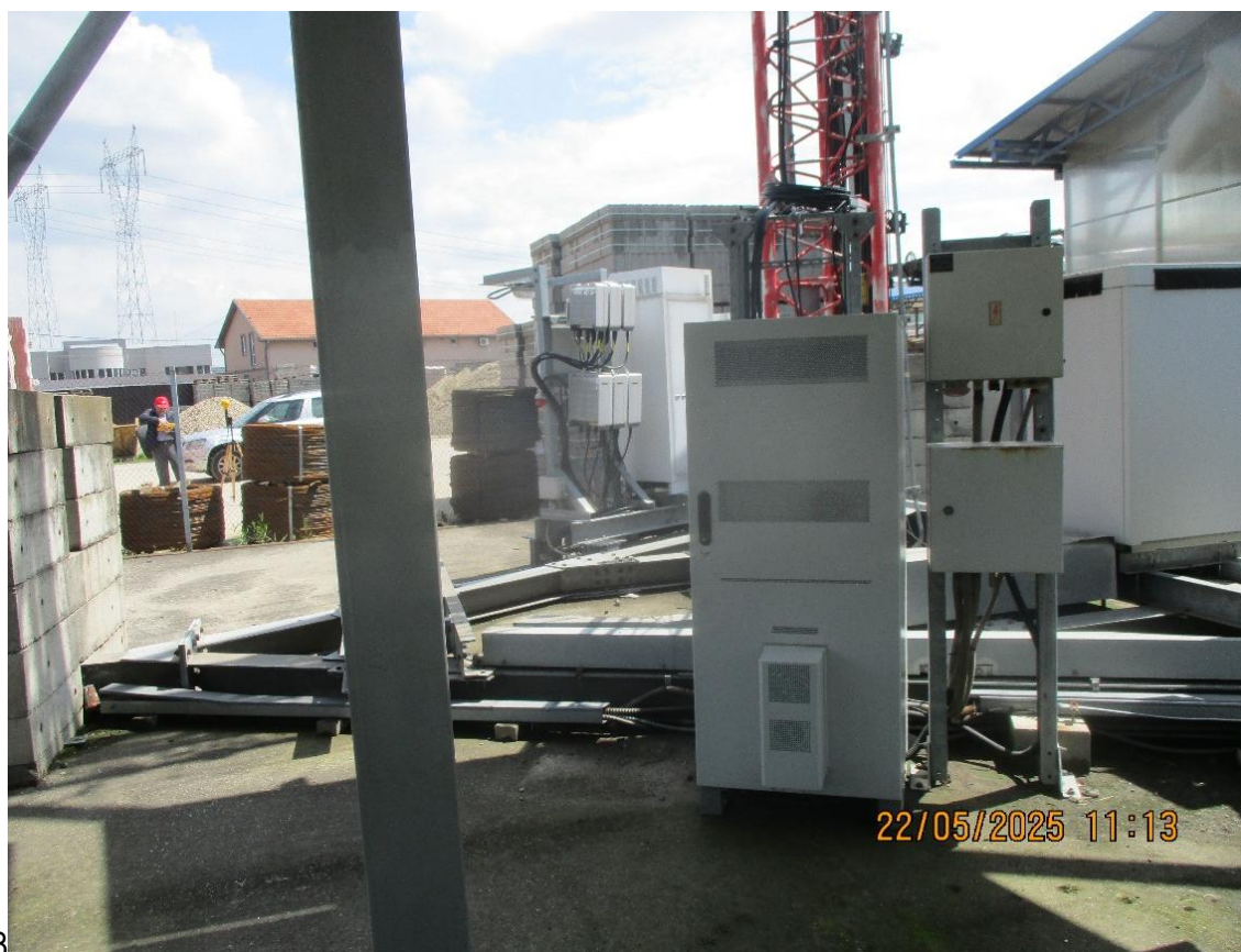
Slika 2.5 Kabinet i antenski sistem BS
