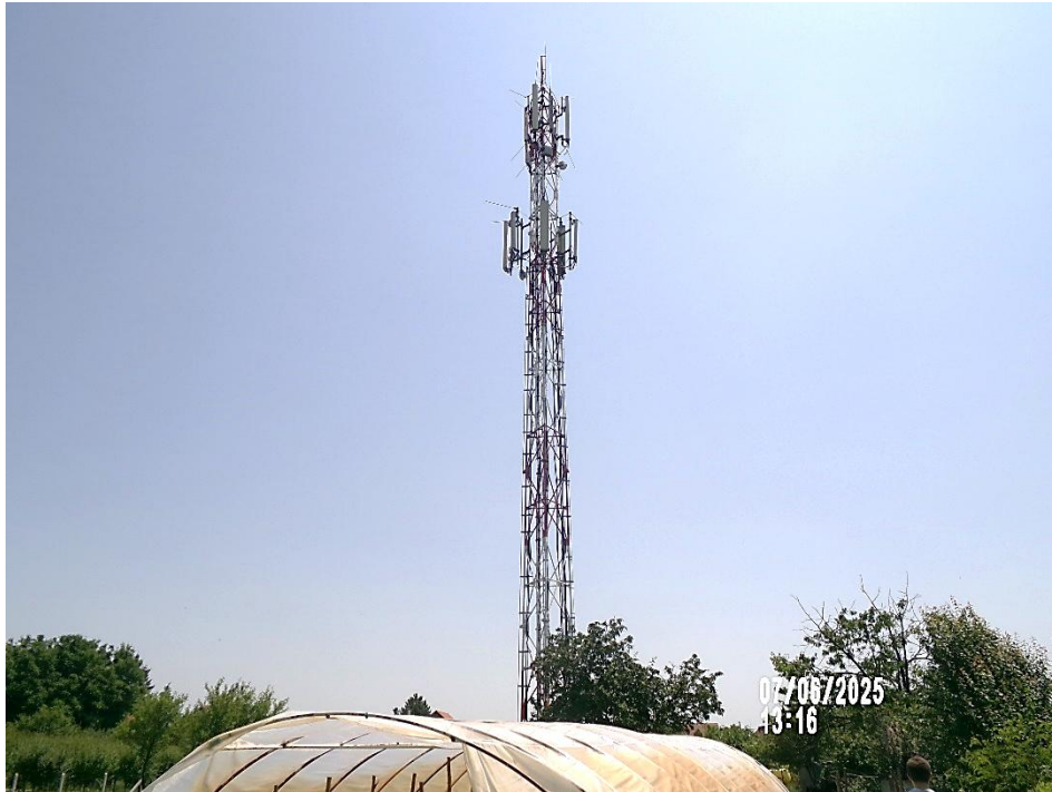
Slika 3: Prikaz stuba na kom je montirana bazna stanica
