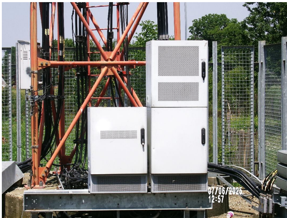
Slika 5 : Prikaz kabineta bazne stanice
