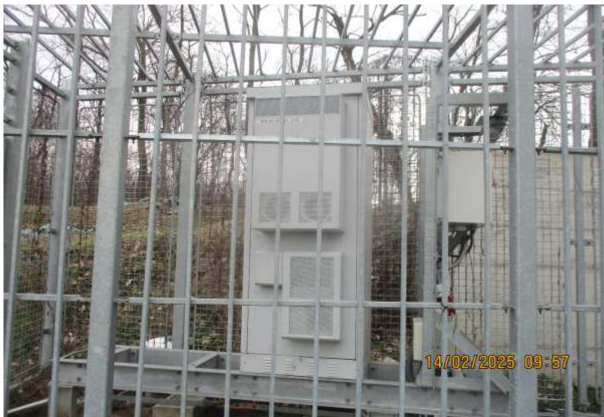
Slika 2.6 Fotografija kabineta predmetne bazne stanice
