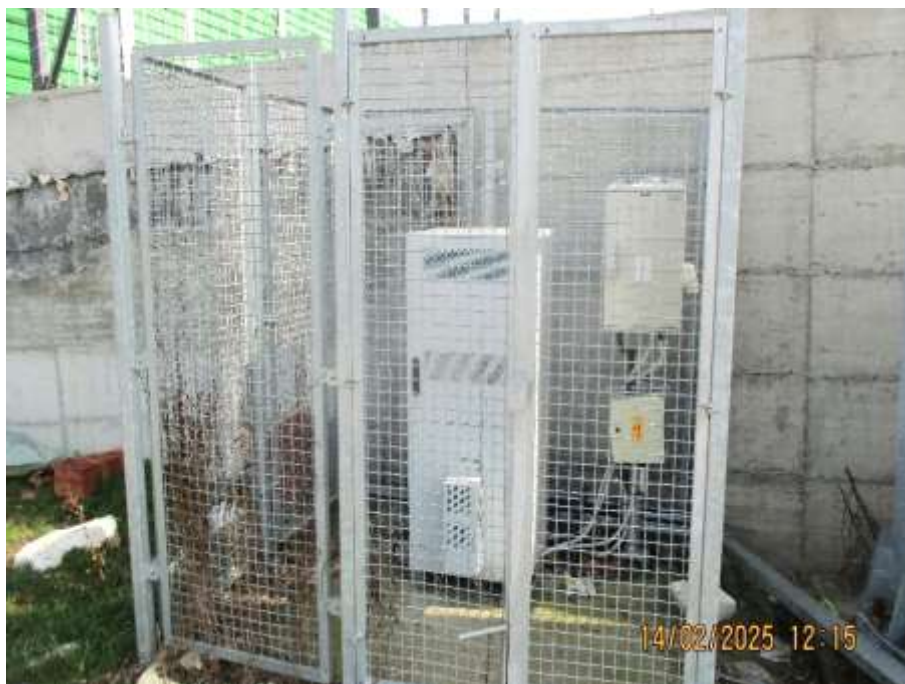
Slika 2.6 Prikaz kabineta bazne stanice
