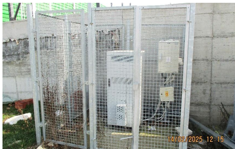
Slika 5 : Prikaz kabineta bazne stanice
