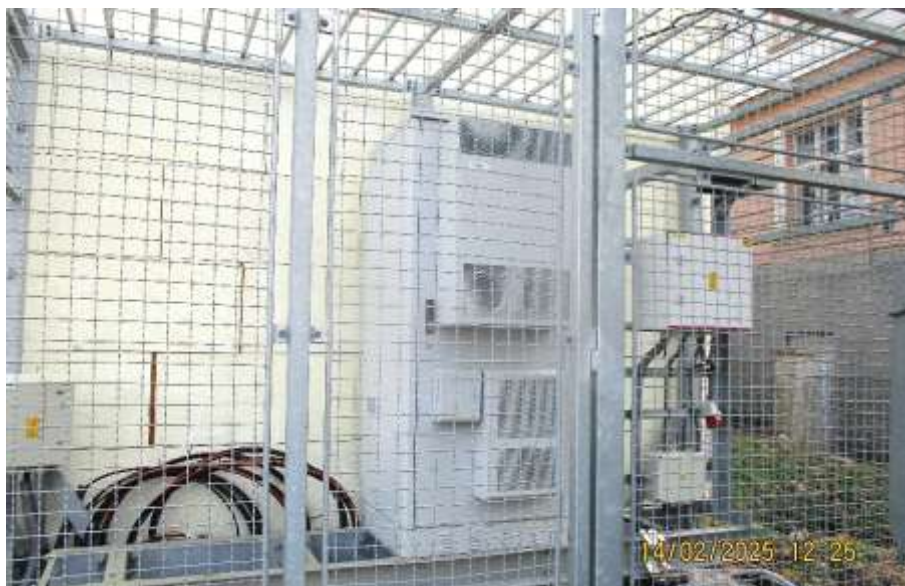
Slika 2.6 Prikaz kabineta predmetne bazne stanice
