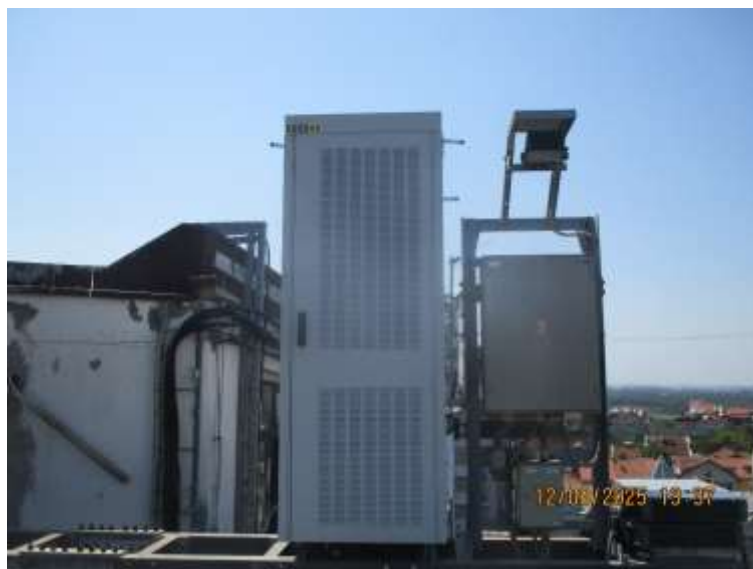
Slika 2.5 Prikaz kabineta bazne stanice
