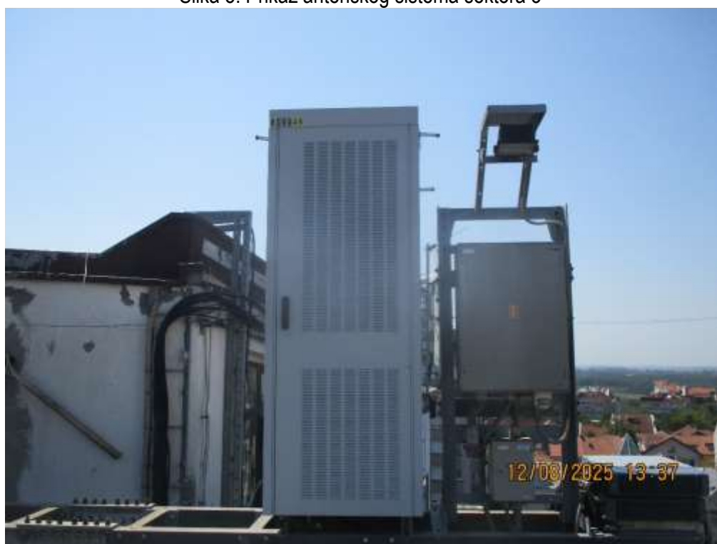
Slika 6: Prikaz kabineta bazne stanice
