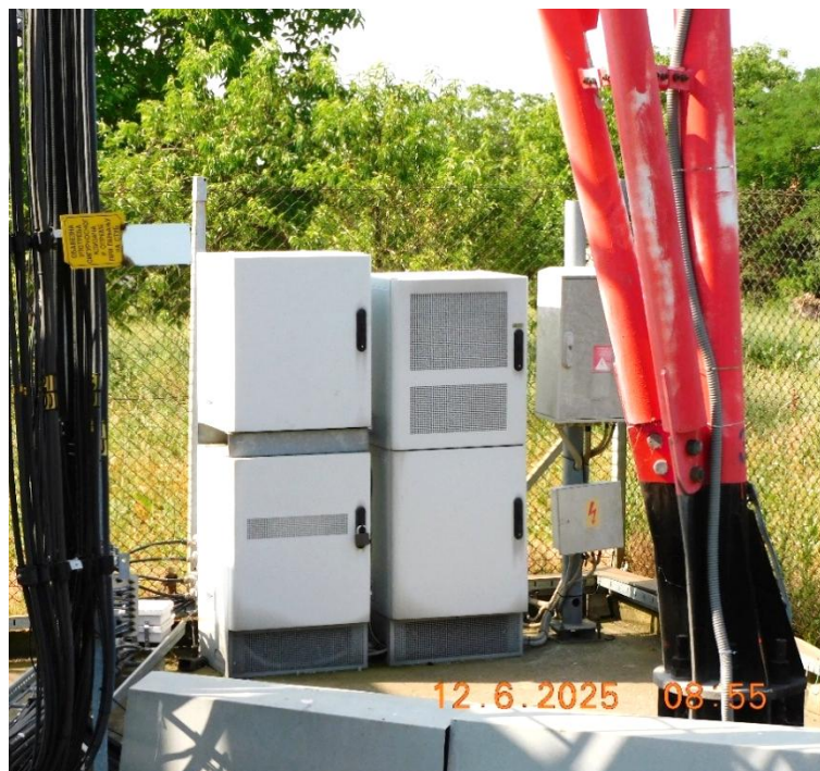
Slika 5 : Prikaz kabineta bazne stanice
