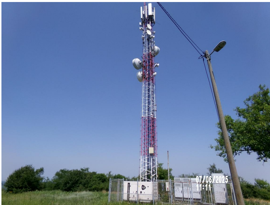
Slika 3: Prikaz antenskog stuba gde je montirana bazna stanica
