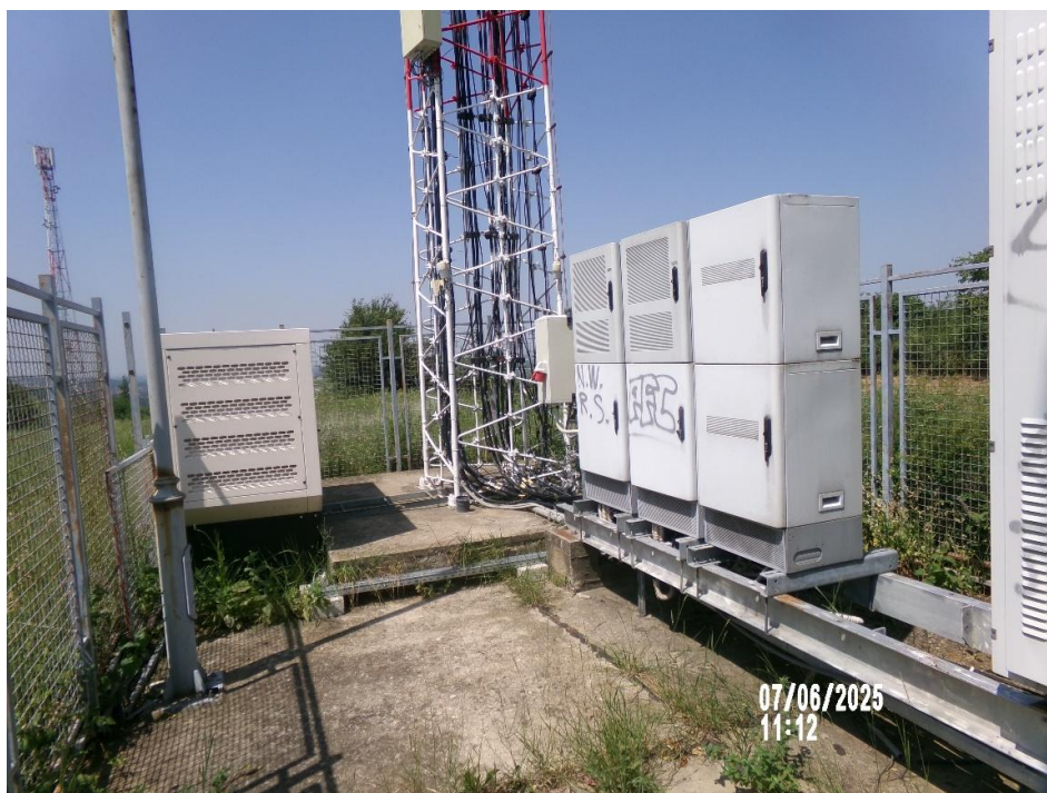
Slika 5 : Prikaz kabineta bazne stanice
