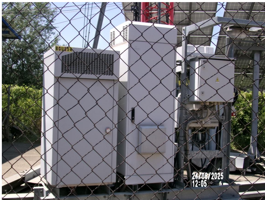
Slika 5: Prikaz kabineta bazne stanice
