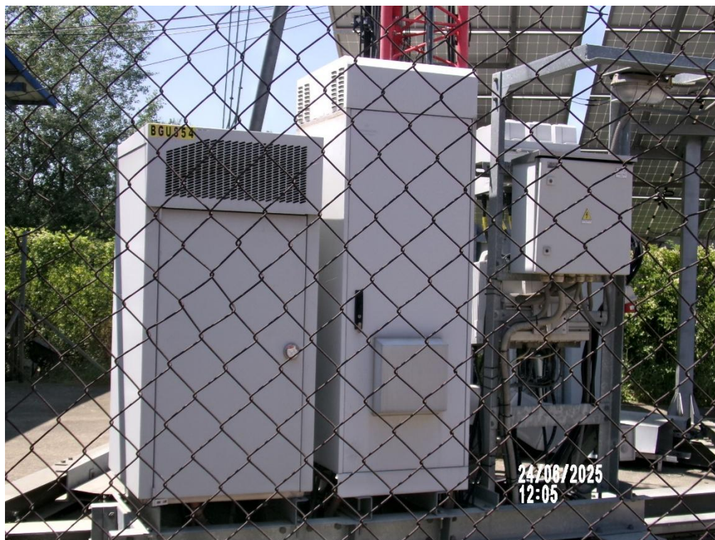
Slika 5: Prikaz kabineta bazne stanice
