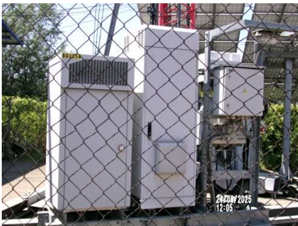
Slika 2.6 Prikaz kabineta Telekom Srbija bazne stanice
