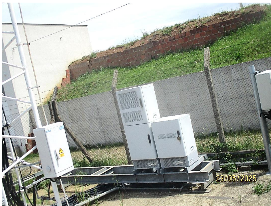
Slika 5 : Prikaz kabineta bazne stanice
