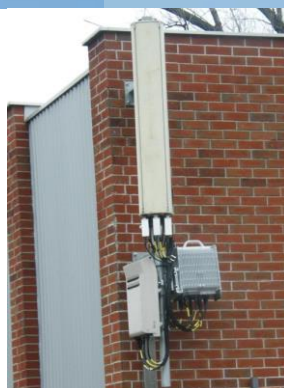
Slika 3.1.3. Fotografija predmetnog antenskog sistema operatora Telekom Srbija i IŽS
