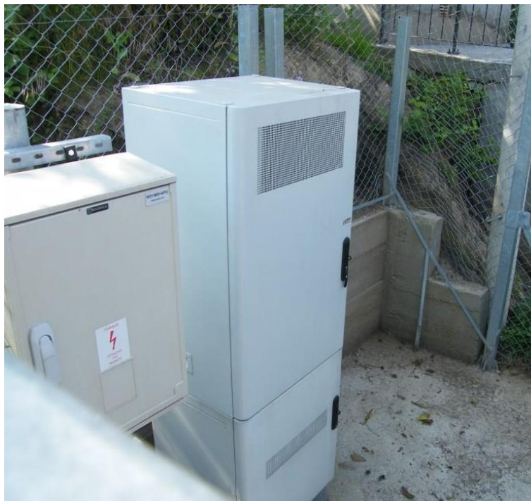
Slika 3.1.4. Fotografija predmetnog izvora zračenja operatora A1 Srbija na lokaciji
