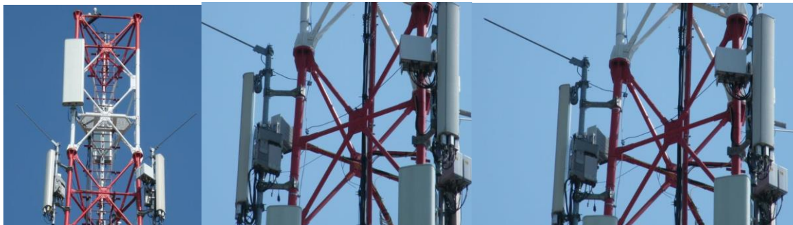
Slika 3.1.3. Fotografija predmetnog antenskog sistema operatora Telekom Srbija i IŽS
