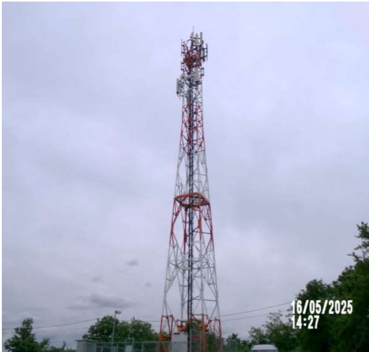
Slika 2.4 Prikaz antenskog stuba na lokaciji bazne stanice
