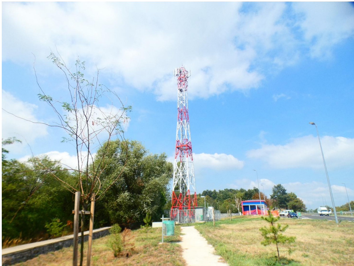
Slika 2.4 Prikaz antenskog stuba na lokaciji bazne stanice
