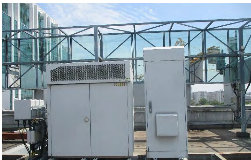
Slika 2.7 Fotografija kabineta bazne stanice
