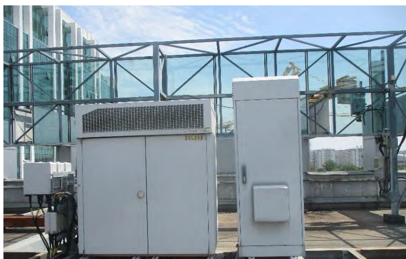
Slika 7: Prikaz kabineta bazne stanice
