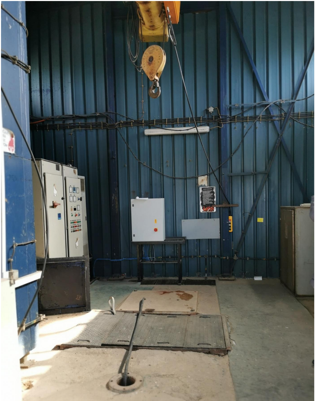
Сл.1.5.1.5.5. Изглед машинске сале-зид трафо просторије, електроормари
