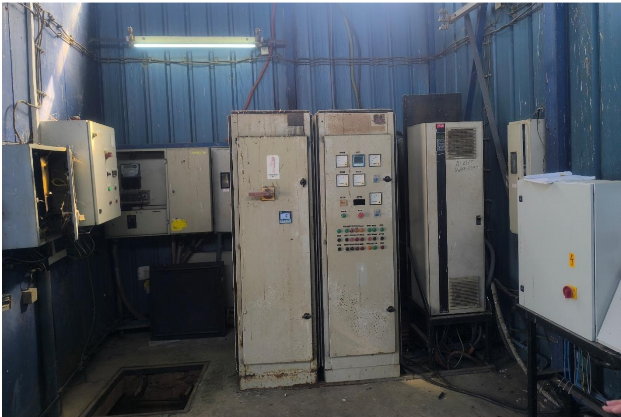
Сл.1.5.1.5.8. Изглед машинске сале- електроормари
