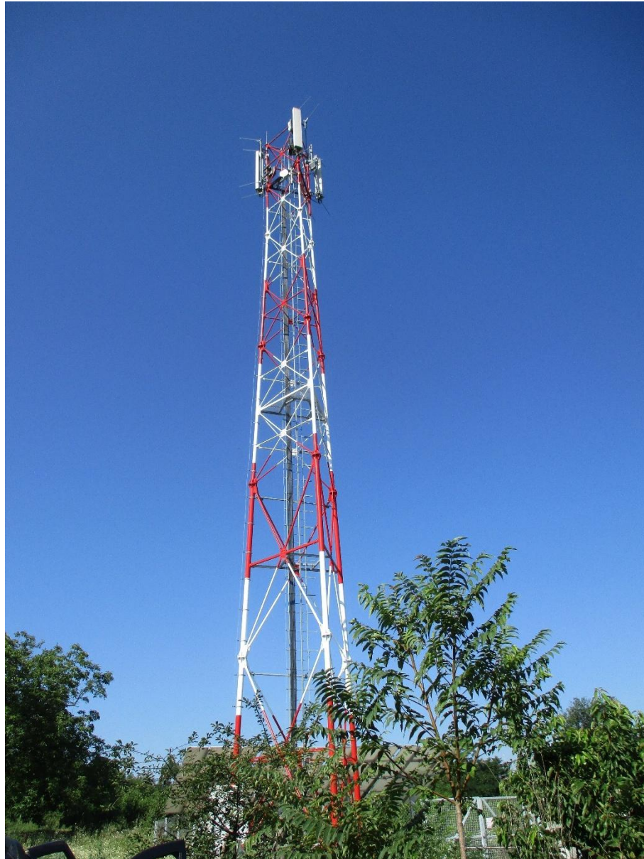
Slika 3.6 Objekat (antenski stub) na kome se nalaze instalacije RBS "BG0769_02 BG_Popovic"
