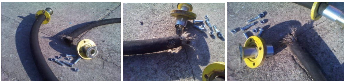
Slika 3.6. Izgled fleksibilnog creva i priključka pre i nakon udesa
