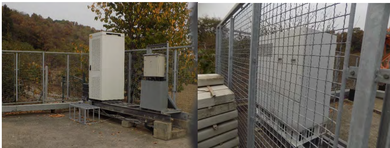
Slika 2.2a. Fotografija RBS-a operatera Telekom Srbija na lokaciji
