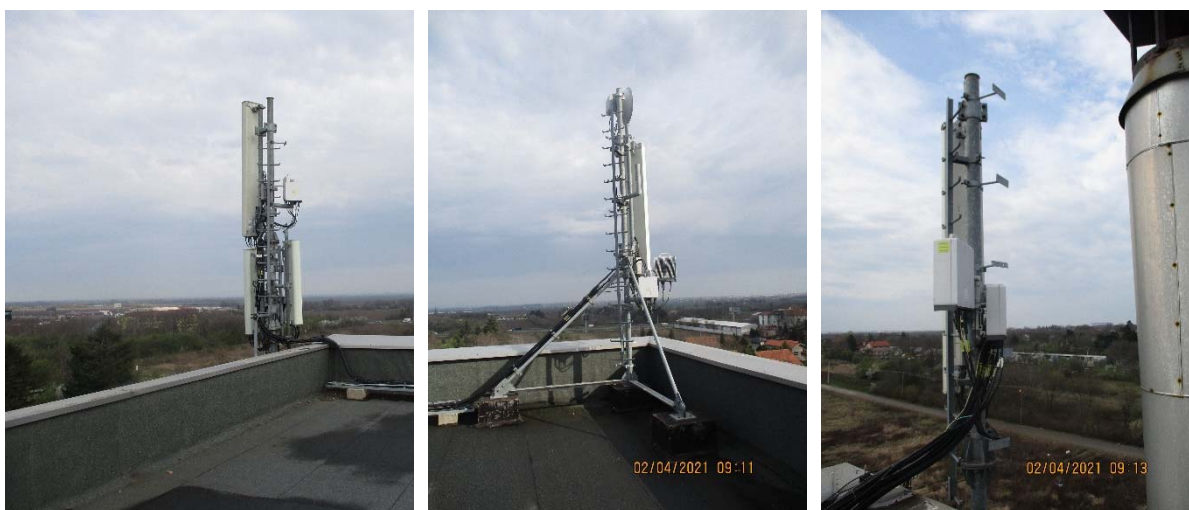
Slika 3.3 Izgled antenskih nosača VIP i bazne stanice Telekoma Srbija
