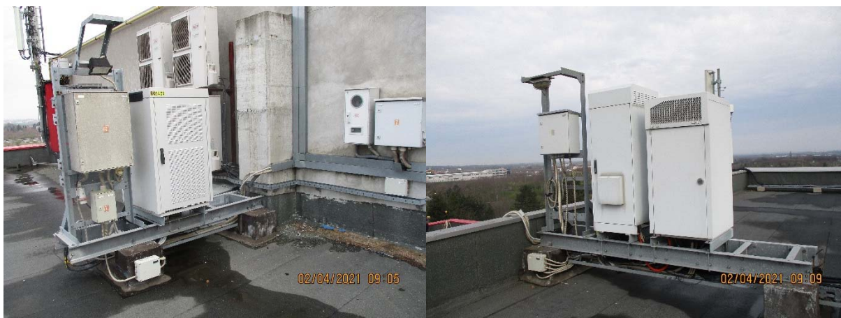
Slika 3.2 Izgled kabineta VIP i bazne stanice Telekoma Srbija
