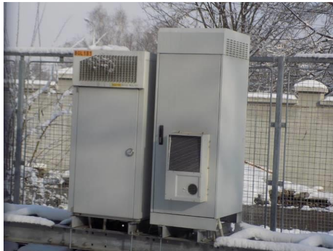
Slika 2.2.b. Fotografija predmetne bazne stanice operatera Telekom Srbija
