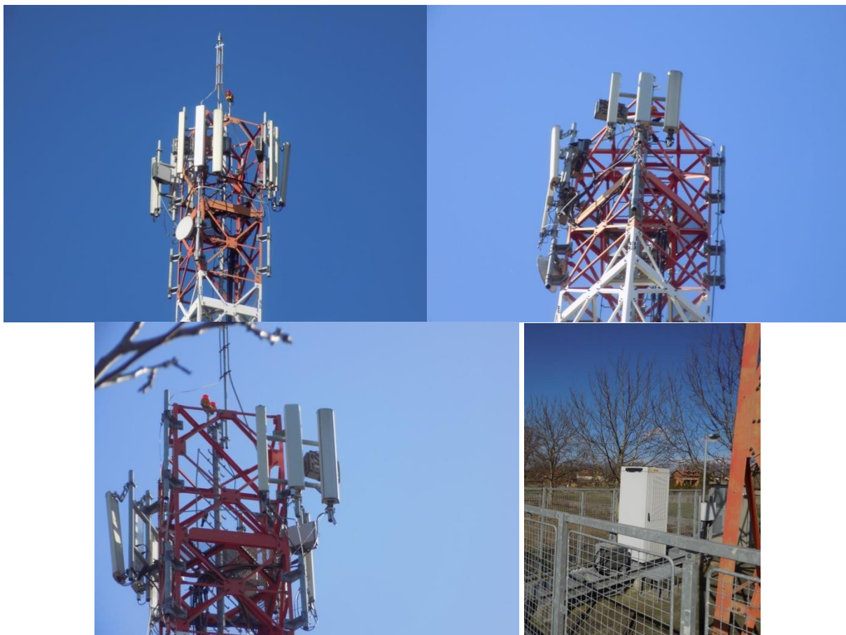
Slika 2.3. Antenski sistem i kabinet predmetne bazne stanice
