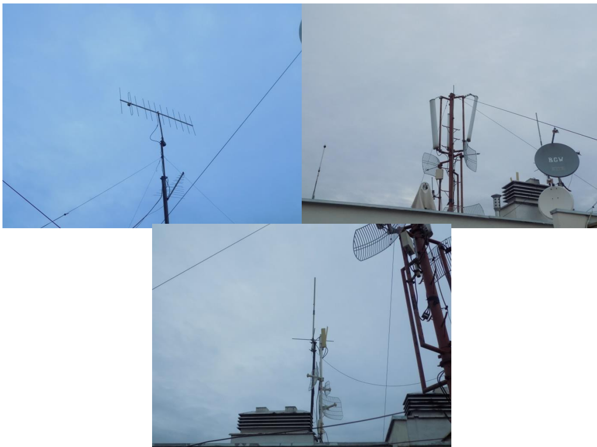
Slika 2.5. Fotografije antenskih sistema na predmetnom krovu
