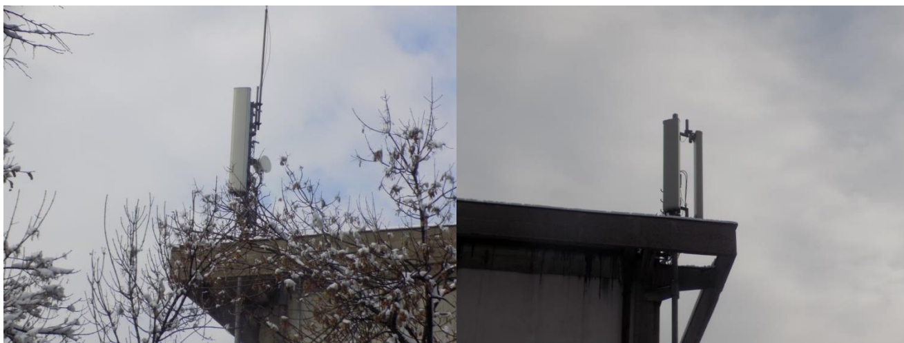
Slika 2.2. Fotografije predmetnog antenskog sistema operatera Telekom Srbija
