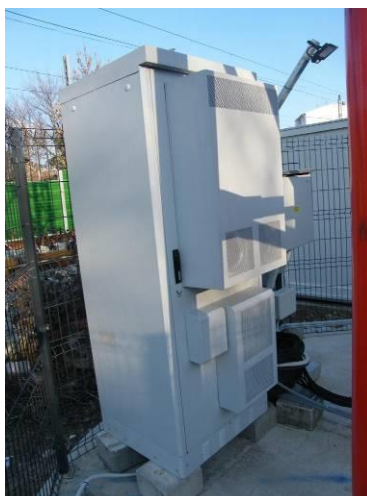
Slika 2.2.b. Fotografija predmetne bazne stanice operatera Telekom Srbija
