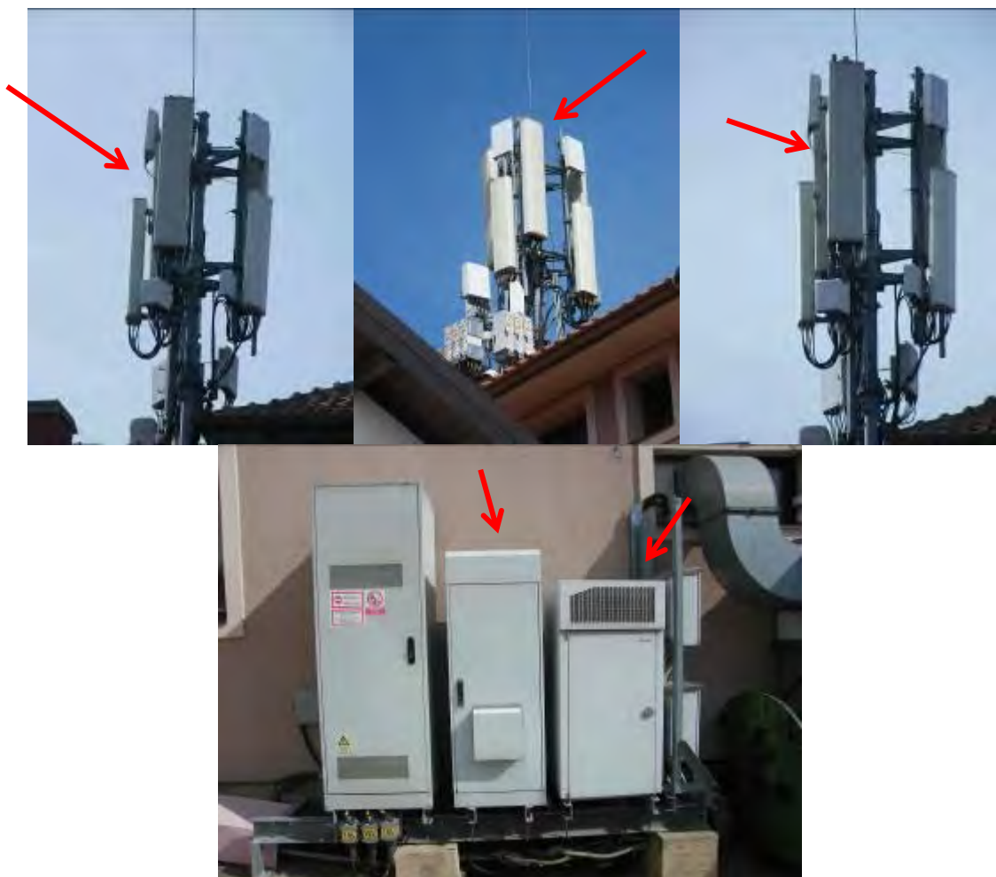
Slika 2.2.a Fotografije antenskog sistema i kabineta predmetne bazne stanice operatera Telekom Srbija
