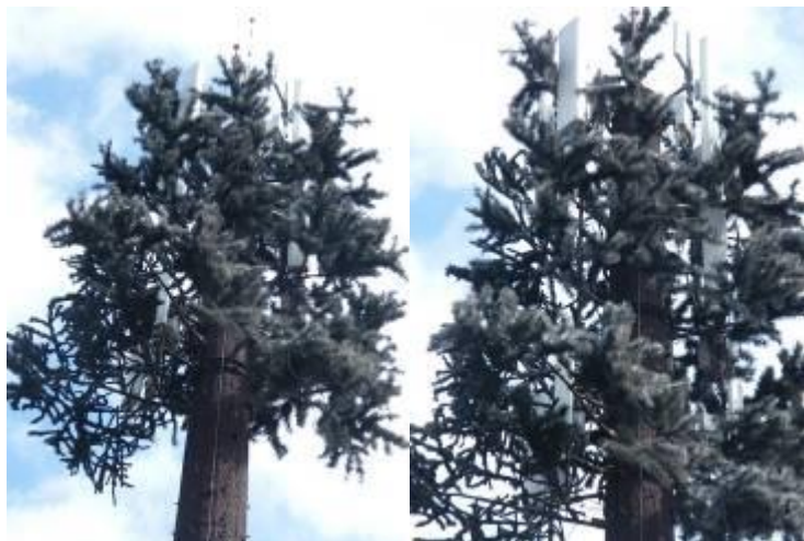
Slika 2.2.a Fotografije antenskog sistema i kabineta predmetne bazne stanice operatera Telekom Srbija
