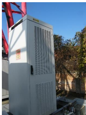
Slika 2.2.b. Fotografije predmetne bazne stanice operatera A1 na lokaciji
