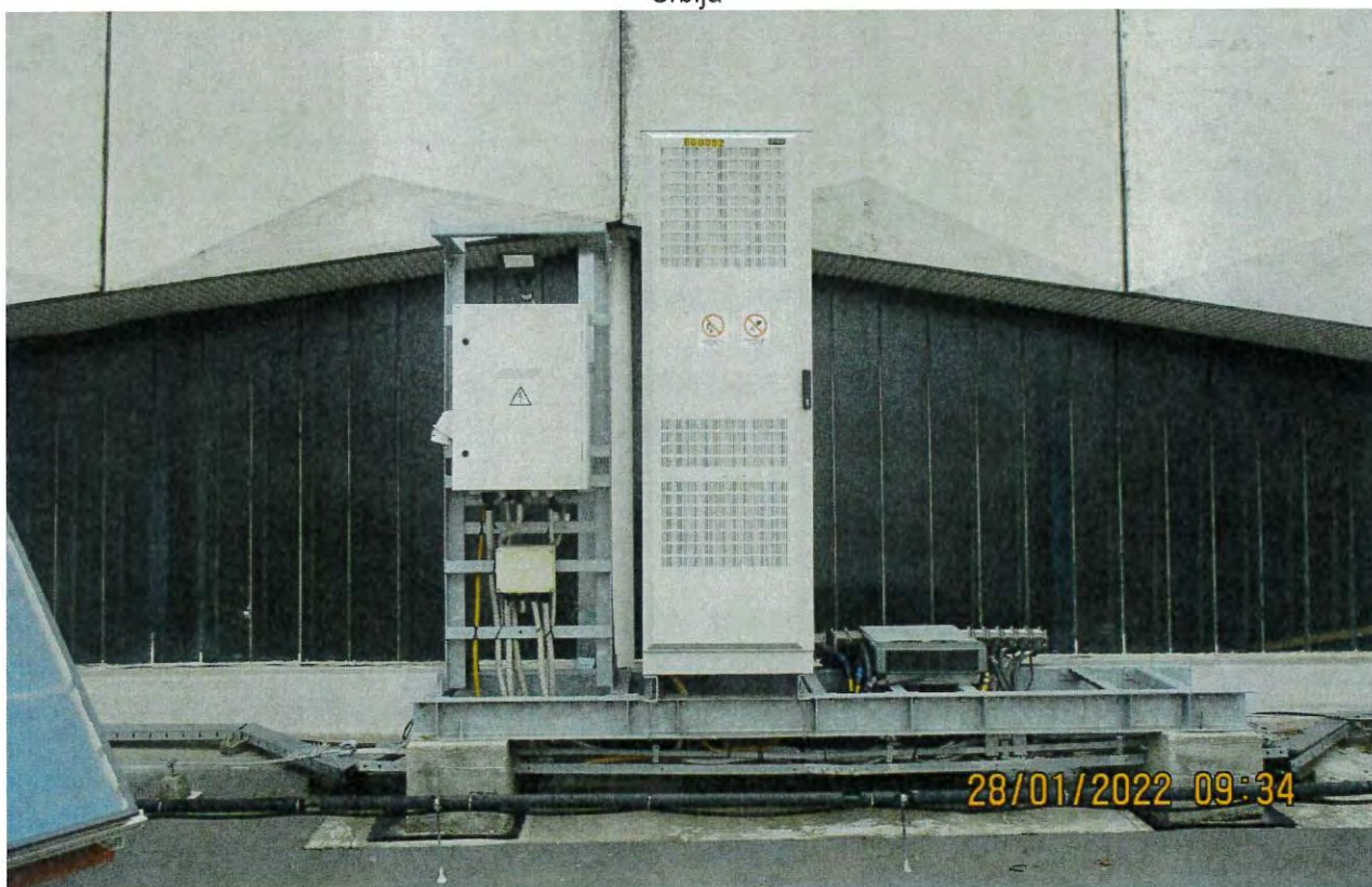
Slika 4: Kabineti bazne stanice BG_Banjica_Sportski_centar operatora A1 Srbija
