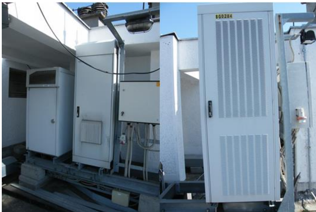
Slika 2.2.b. Fotografija predmetne bazne stanice operatora Telekom Srbija i bazne stanice operatora A1 Srbija
