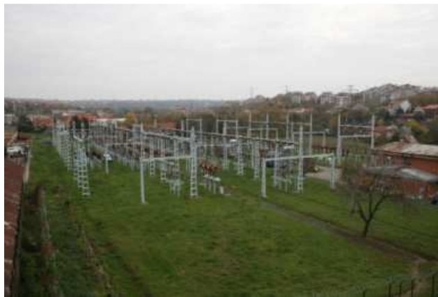
Слика 7: Постојећа трафо станица 220/110kV
