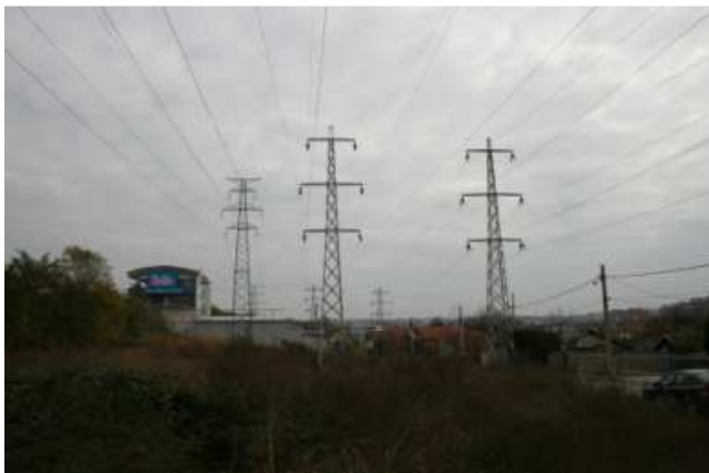
Слика 6: Постојећи надземни далеководи 35 и 110kV
